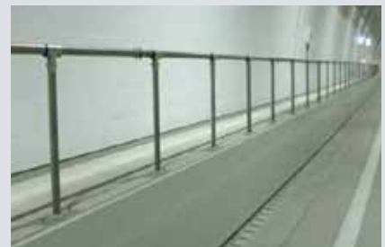
トンネル内ハンドレール (ZAM ® 製鋼管)
